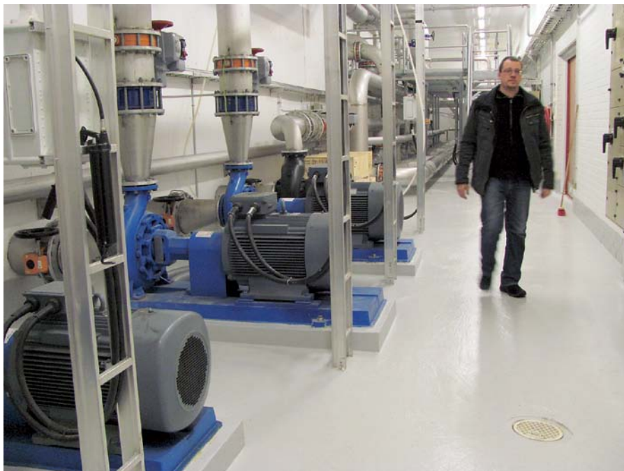
Esa Puolakka tarkastaa haukankatseellaan keinopohjaveden pumppaamo...
